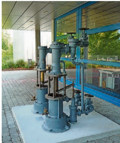
Die hydraulische Widderanlage, vor dem BBZ aufgestellt. ZVG
